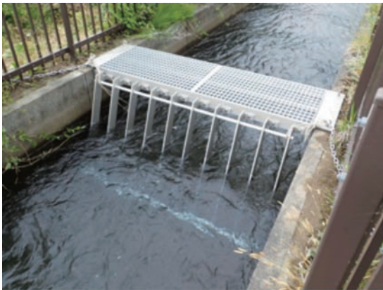
図12 除塵スクリーン Dust removal screen
