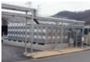
▲水と物スラリ蓄熱空調システム
