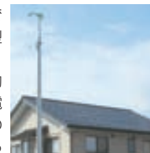
▲一般住宅に設置された小型風力発電機
