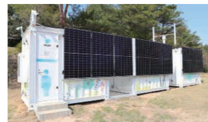
多度山上公園（三重県桑名市多度町）にエコトイレとして設置された「N³エヌキューブ」
