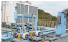
冷却水ポンプをインバータ化
