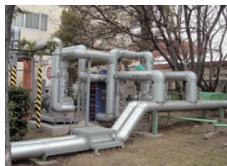
磐田製作所(静岡)にある温排水パイプラインと熱交換器
