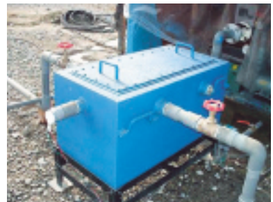
地下水浄化装置
