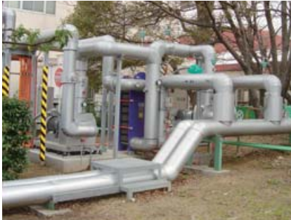
温排水パイプラインと熱交換器
